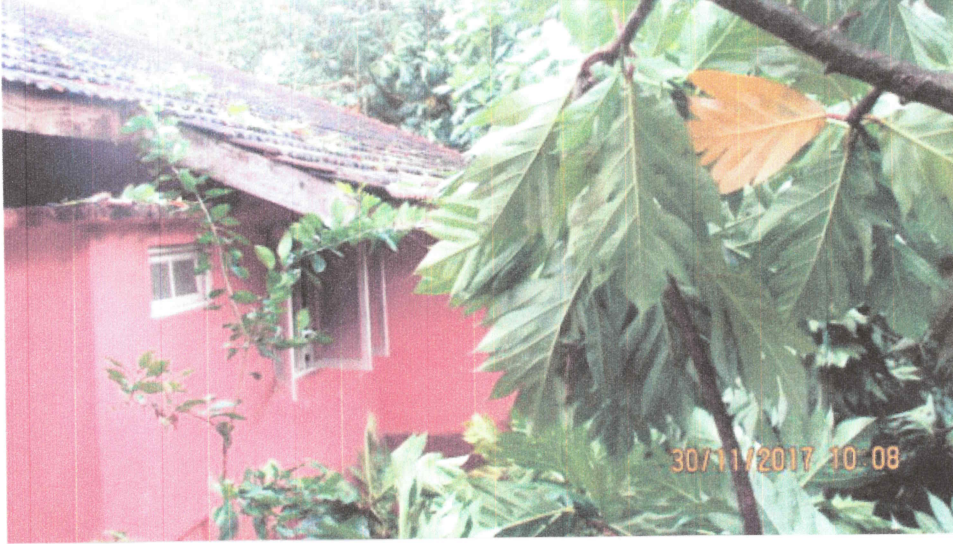
Umgestürzte Bäume zerstörten das Dach, das Badehaus und die Küche des Mädchen-Waisenhauses "Vijitha" in Beruwala
